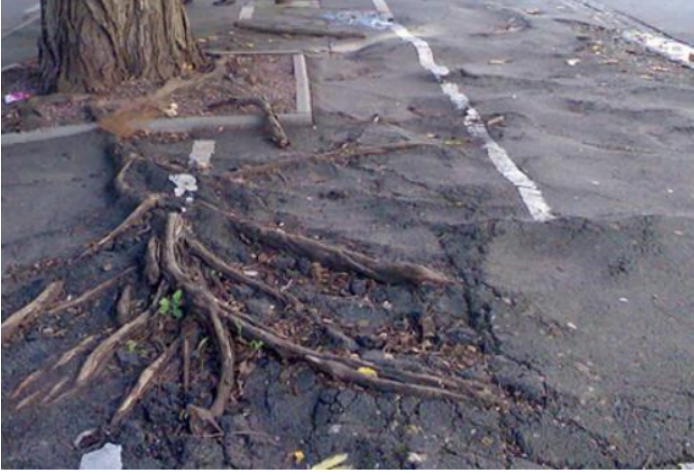
Şekil 2. Ağaç köklerinden dolayı yol kaplamalarında oluşan hasarlar (Alani & Lantini, 2019)
