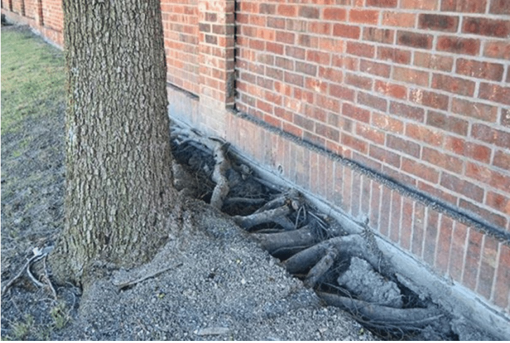
Şekil 1. Temellerin altında büyüyen ağaç kökleri (CNT Foundations, 2020)
