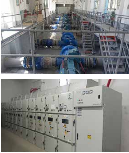
Şekil 6. Revizyon çalışmalarından sonra motor/pompa yapısının dışarıdan görünümü(a), Revizyon sonrası pano odası görünümü(b)
