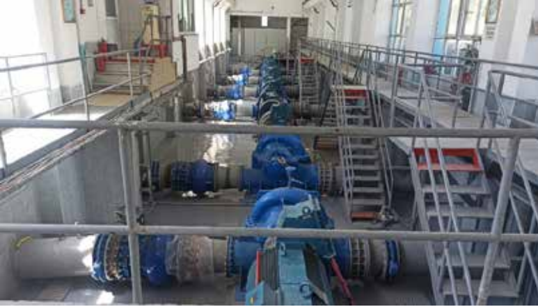
Şekil 1. Kağıthane Eski Terfi Merkezi Pompa Grubu.
