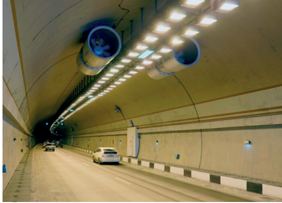
Şekil 6: Tünelde Kullanılan Jet Fan.
