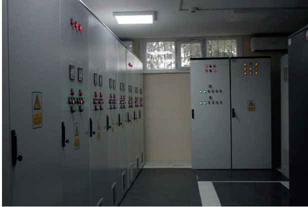
Şekil 7: Tüneldeki Ana Dağıtım Pano Odası.
