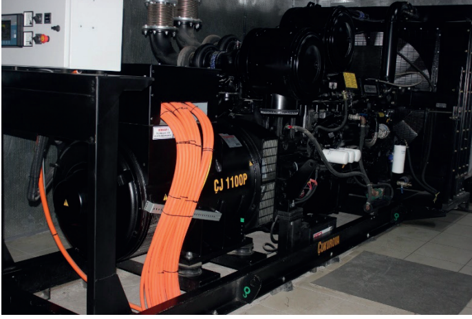
Şekil 4: İncelemeye Konu Olan Vecdi Diker Tünelinde Kullanılan Jeneratör.
